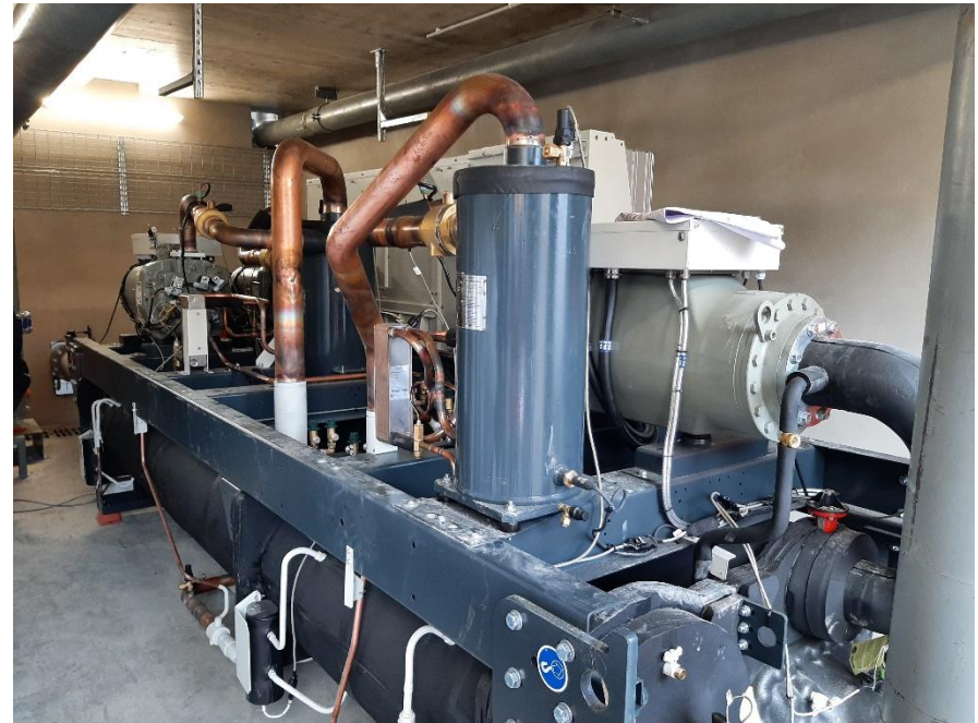
Installations de trois pompes à chaleur associées aux Terraos
